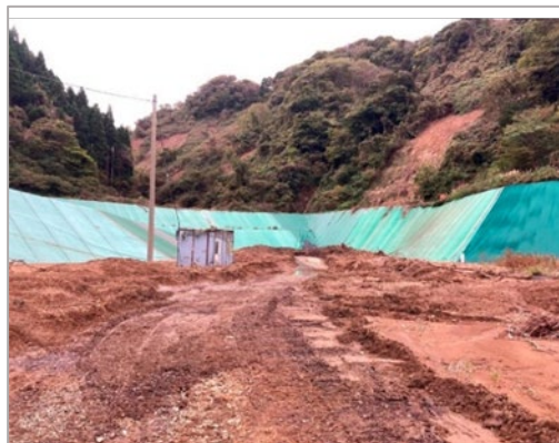
①大量の土砂の流入
