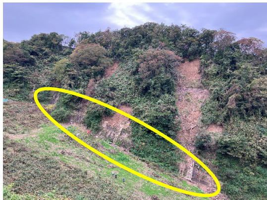
②左岸部地山の崩壊 による雨水側溝の埋没
