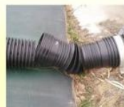
ガス抜き管の破損例
