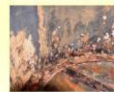
砂ろ過塔腐食状況
