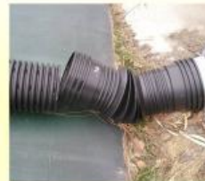
ガス抜き管の破損例
