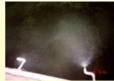
散水設備の例
