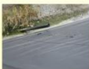
法面ガス抜き管の破損
