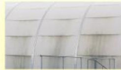
被覆施設の膜面の汚れ
