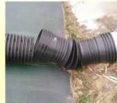
ガス抜き管の破損例
