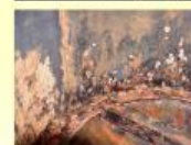
砂ろ過塔腐食状況
