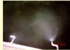
散水設備の例
